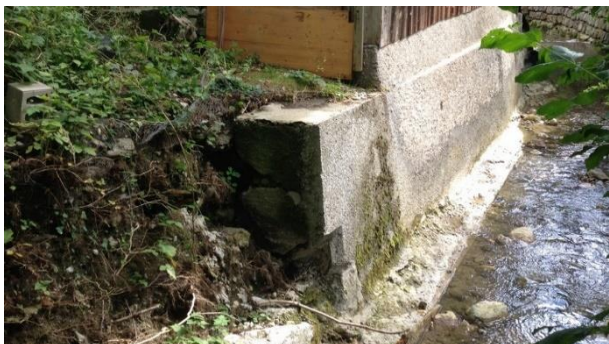
Kilometrierung 1860, erodiertes Ufer, stromabwärts
